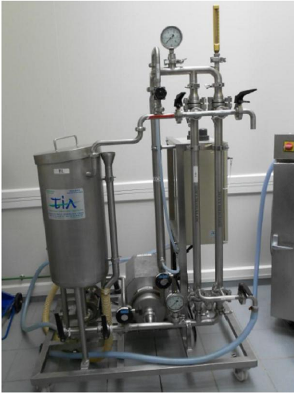
Unité pilote d'ultrafiltration TIA
